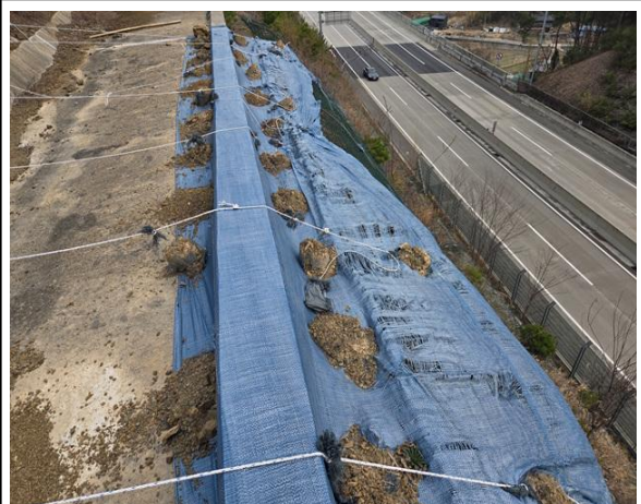
위 치 STA 37.21k 1단 사면 현 황 표층유실부 임시보수
